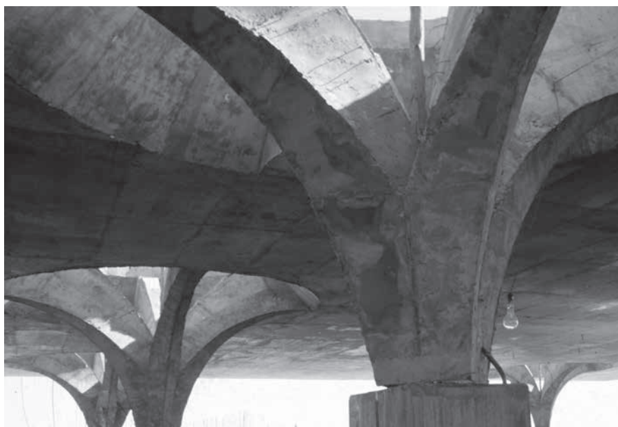
Figura 1. Estructura de la losa de cobertura de la Rodoviária de Jaú (1973-1976), proyectada por João Batista Vilanova Artigas. Fuente: Arquigrafia. Licencia Creative Commons (CC 3.0 BY-NC-ND).
